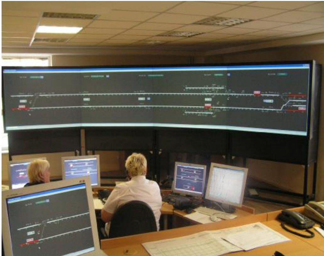
Рис. 2 Центр диспетчерского управления
